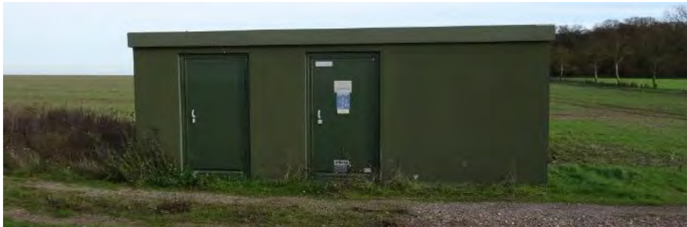
Photographie 41 : Exemple de poste de livraison avec peinture vert foncé (source : ABIES)
