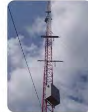
Vue du mât avec ses haubans et ses 2 panneaux solaires (plaques horizontales)
